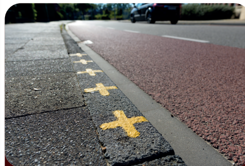
Abb. 3: „Gelbe Grenzkreuze“ entlang der Bordsteinkante
