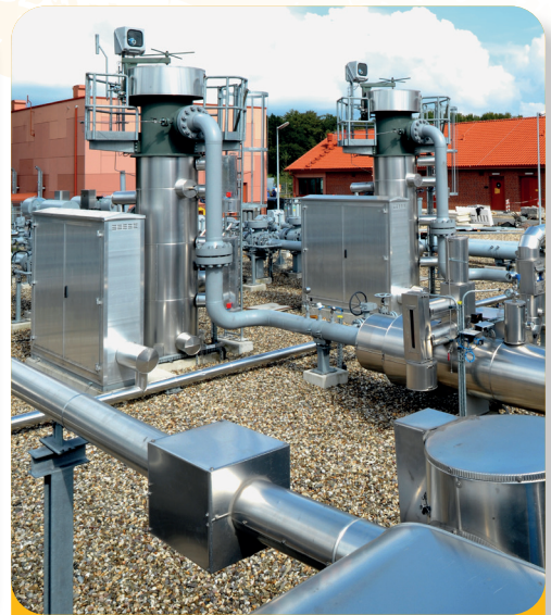
Abb. 6: Oberirdische Details der Kavernenanlage Gronau-Epe der Trianel GmbH
